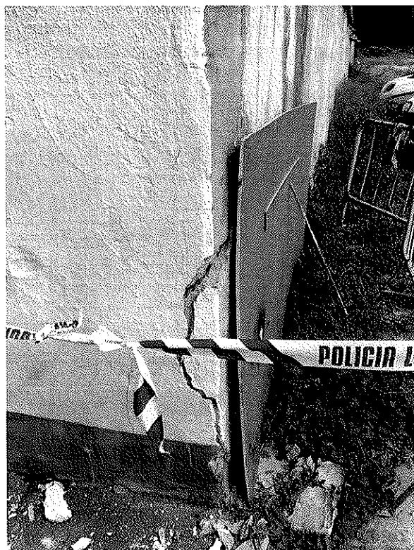
Señalización policial y protección provisional.
