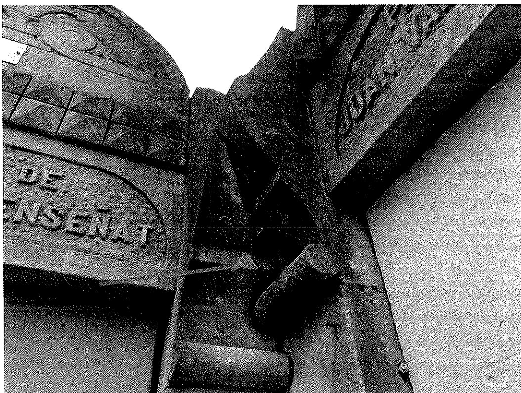
Grietas en el elemento interior escultórico protegido por Patrimonio.
